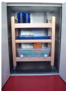
Modernisierter Aufzug in einer Kindertages- einrichtung in Dresden
